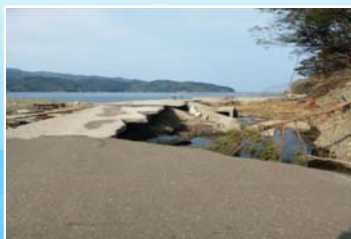
液状化被害の大船戸を視察 (平成23年5月19日)
