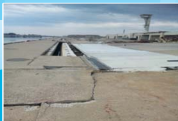
液状化被害の閉上を視察 (平成23年5月21日)
